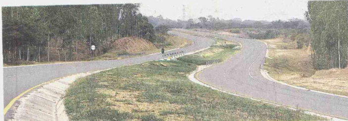
Al corte del pasado 28 de febrero, toda la concesión registraba un avance del 74 % en construcción y presupuesto. A. particular
