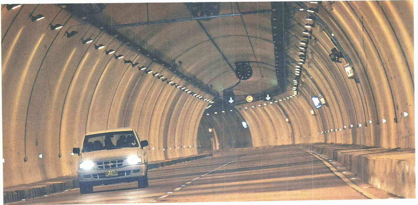
Los problemas de revestimiento en el túnel de El Boquerón, en la vía Bogotá-Girardot, tiene en alerta a las autoridades de la infraestructura / Archivo El Espectador.
