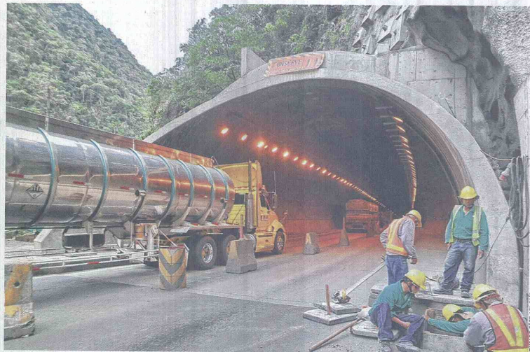
Infraestructura. Actualmente se encuentran en operación los túneles 3, 4, 5, 6 y 7 (izquierdos) en el tramo Loboguerrero Cisneros de la doble Calzada que se construye en la vía hacia el Puerto de Buenaventura.
